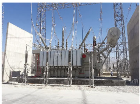
پست باغملک، سال ساخت: ۱۳۹۹ توان 200 MVA؛ ولتاژ 400/132/20 kV
