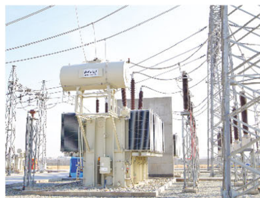
پست بهارستان، سال ساخت: ۱۳۹۸ توان 180 MVA؛ ولتاژ 230/63 kV
