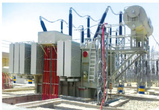
پست پالایشگاه گاز بیدبلند خلیج فارس، سال ساخت: ۱۳۹۵ توان 85 MVA؛ ولتاژ 230/20 kV
