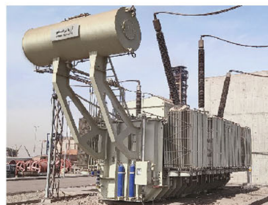
مجتمع صنعتی و معدنی گل گهر سیرجان، سال ساخت: ۱۴۰۰ توان 270 MVA؛ ولتاژ 400/33 kV
