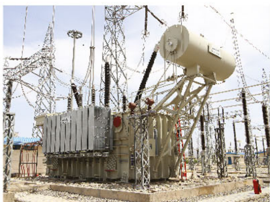
پست سرداران، سبزوار، سال ساخت: ۱۳۹۹ توان 200 MVA؛ ولتاژ 400/132/20 kV
