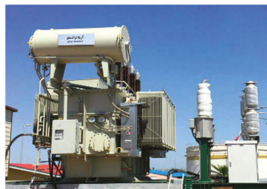
نیروگاه سیار مینا، پست بهشهر، سال ساخت: ۱۳۹۵ توان 32 MVA؛ ولتاژ 66/11 kV
